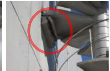
外部階段破損
