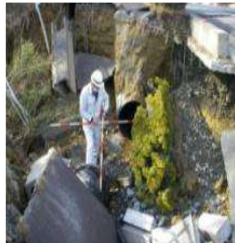
破断した配水管（止水済み）
