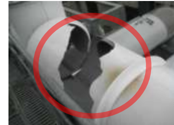
排ガス処理設備ダクト破損
