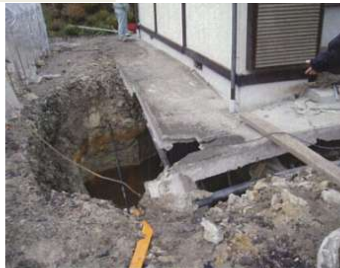
被害例1： 地震により旧鉱物採掘区域が崩落し、家屋の下に深さ約2.5mの陥没が発生
